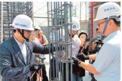
鋼筋與隔震磚是增加耐震設計，圖為建築安全聯盟協會理事專家魏豐現場講解抗震原理。
