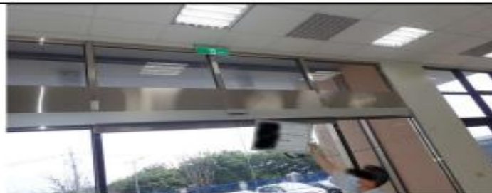
出口標示燈移位設置照片
