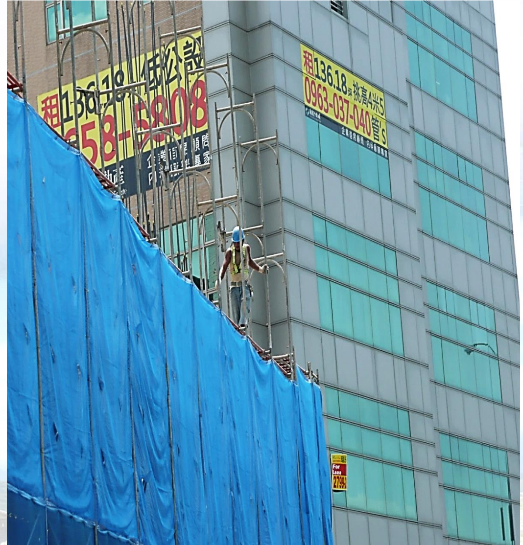
高處施工架組拆作業勞工未使用安全帶、站立在未設交叉拉桿、下拉桿施工架工作臺上
