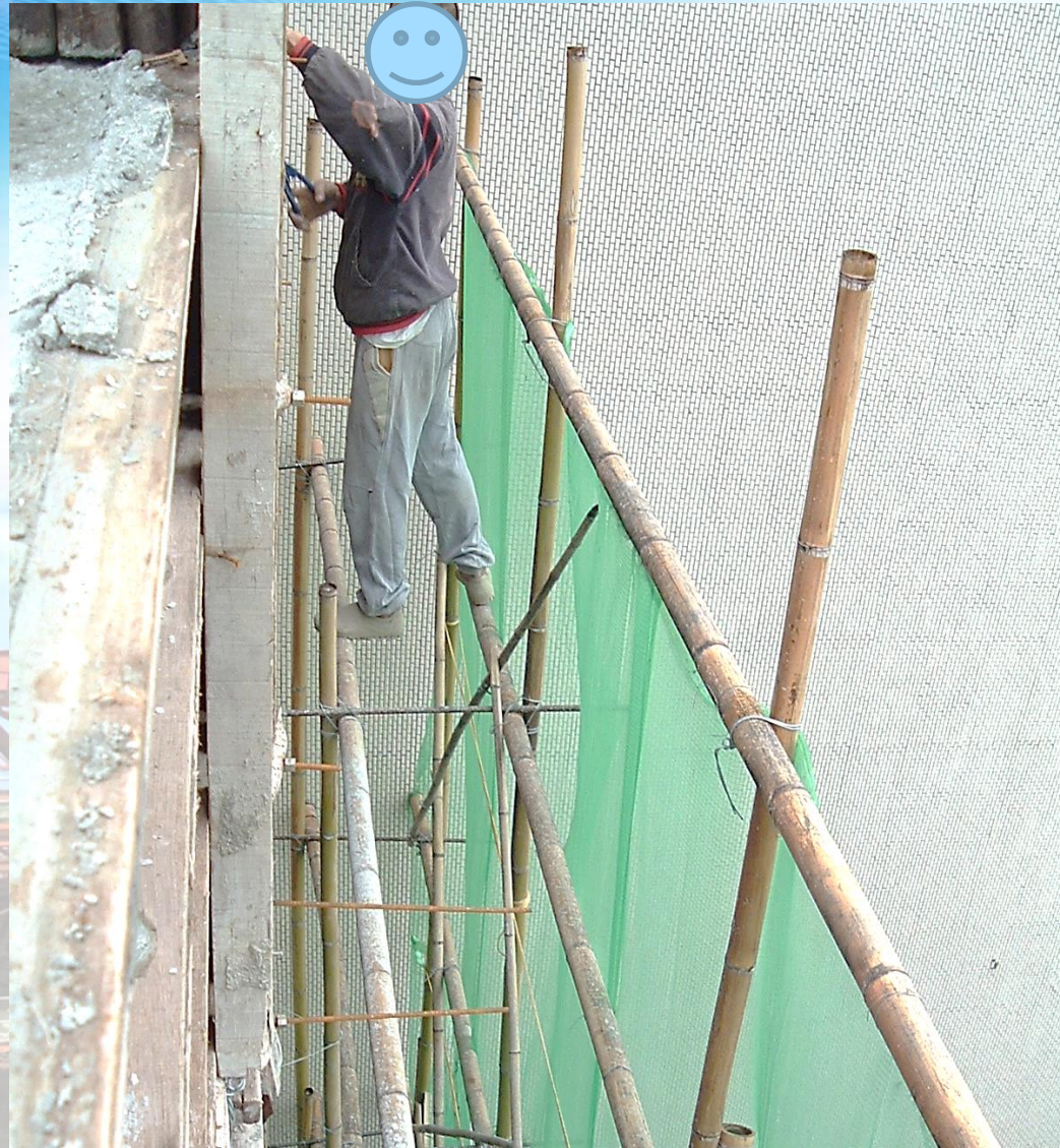
高處粉刷作業勞工未使用安全帶及未戴用安全帽站立在未設踏板竹鷹架上
