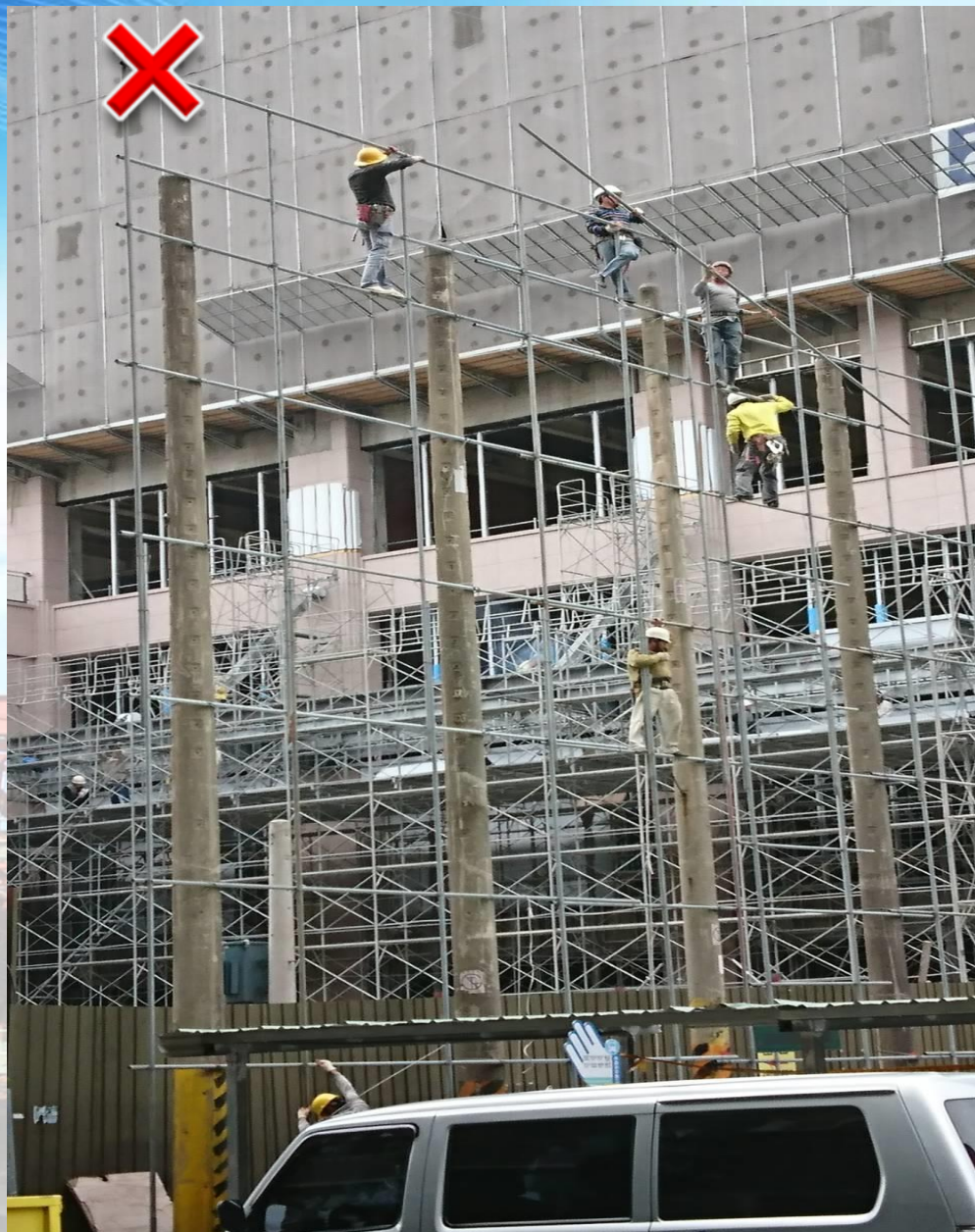
2公尺以上高處作業未繫掛安全帶等
