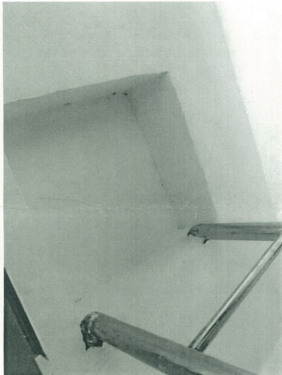
地下一層爬梯式急出口封閉無法開起
