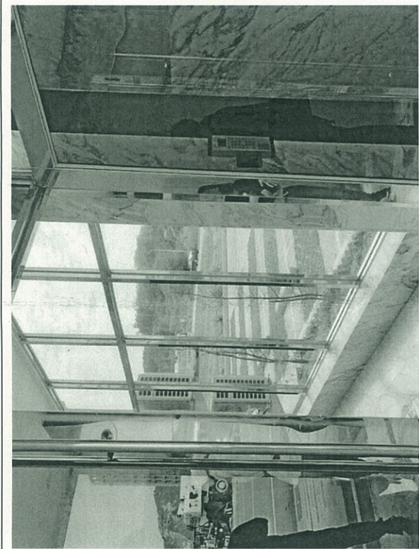
各層梯廳外牆開口不符防火間隔規定
