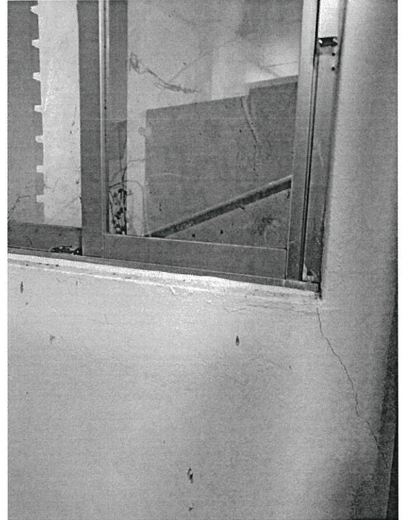
一樓右後側 2 扇窗戶窗角有裂縫及滲水情形。
